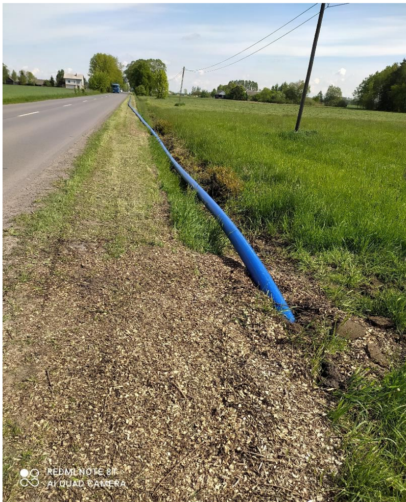
Sieć wodociągowa – Julianów – Przykwa
