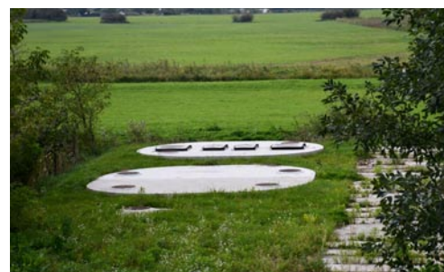
Osadnik i separator kanalizacji deszczowej
