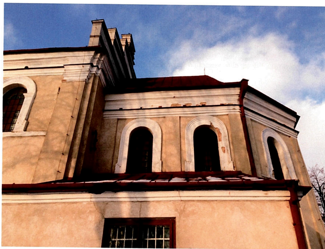
Fot. 31 Kościół p.w. Św. Józefa w Markuszowie. Widoczny stan cokołu – odpadające połączenie wierzchniej warstwy zaprawy.
