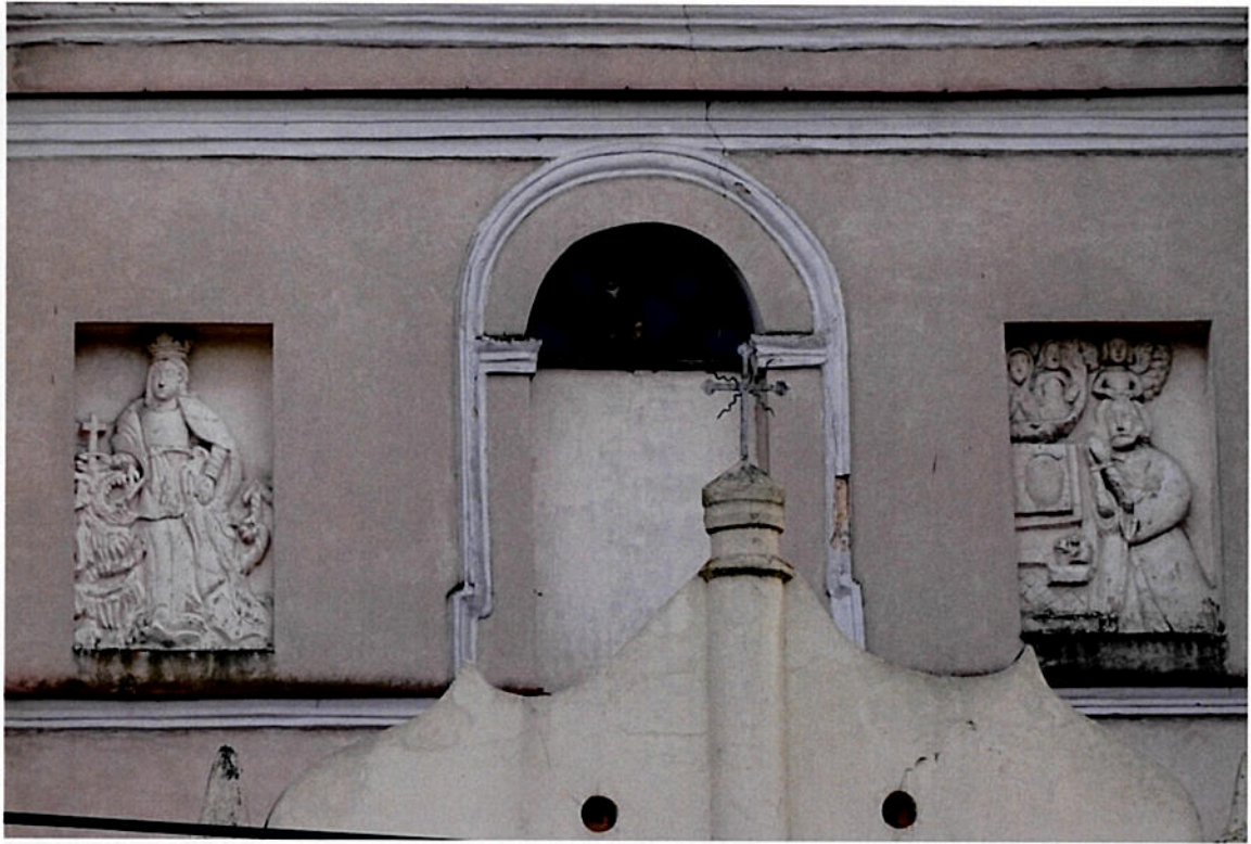
Fot. 7-9 Kościół p. w. Św. Józefa w Markuszowie. Elewacja frontowa, dwie zewnętrzne płaskorzeźby umiejscowione wzdłuż trzeciej kondygnacji; w środku – zamurowane okno. Widoczny bardzo zły stan płaskorzeźb. Zatracona, sprymityzowana forma oraz zły stan techniczny na skutek wykonanych napraw i wtórnych nawarstwień cementowych. Wyraźnie widoczne zaciemnienia tynku – zawilgocenia, prawdopodobnie zagrzybienia, odparzenia.
