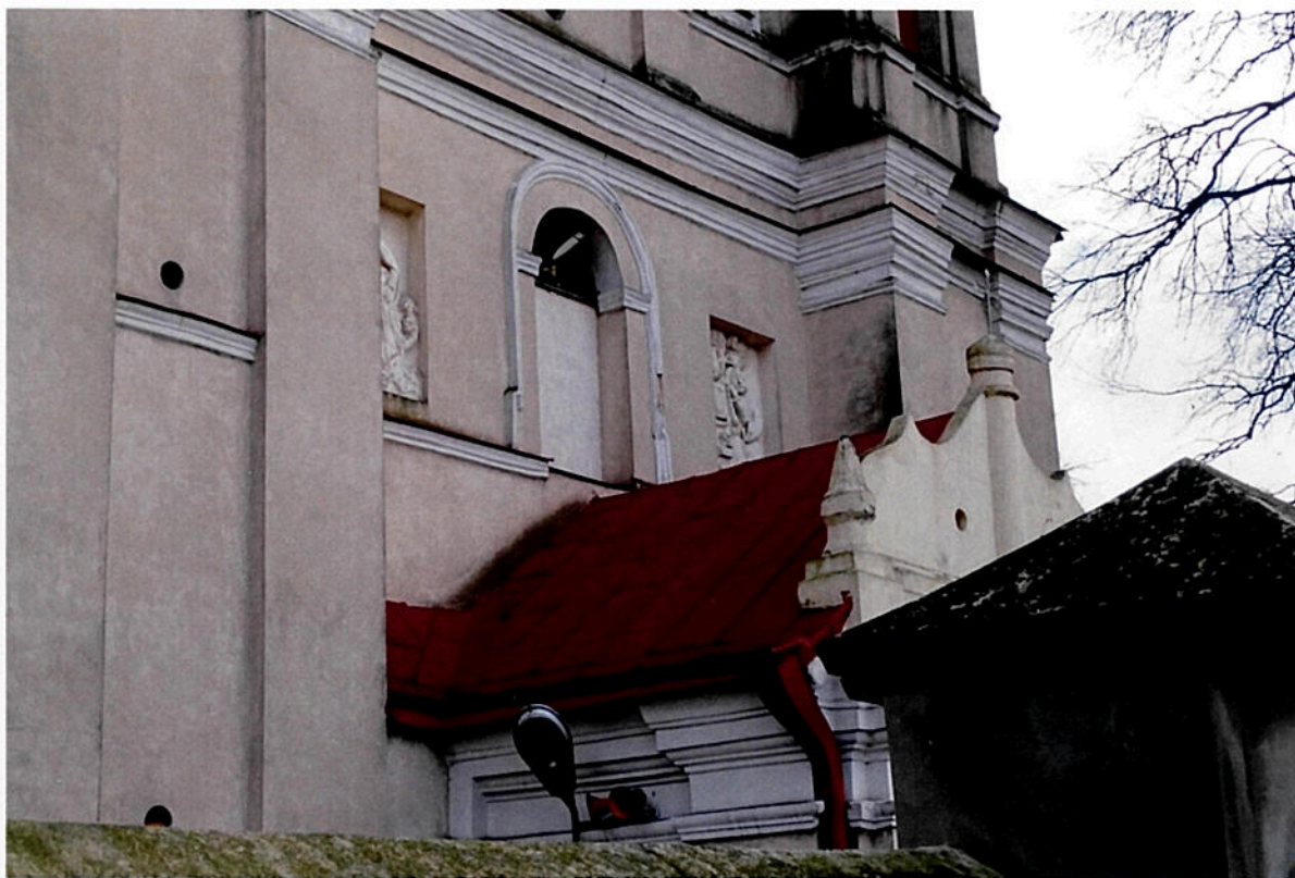
Fot. 11, 12 Kościół p. w. Św. Józefa w Markuszowie; widok na elewację frontową. Widoczne zaczernienie – zawilgocenie tynków, w szczególności na zwieńczeniu.
