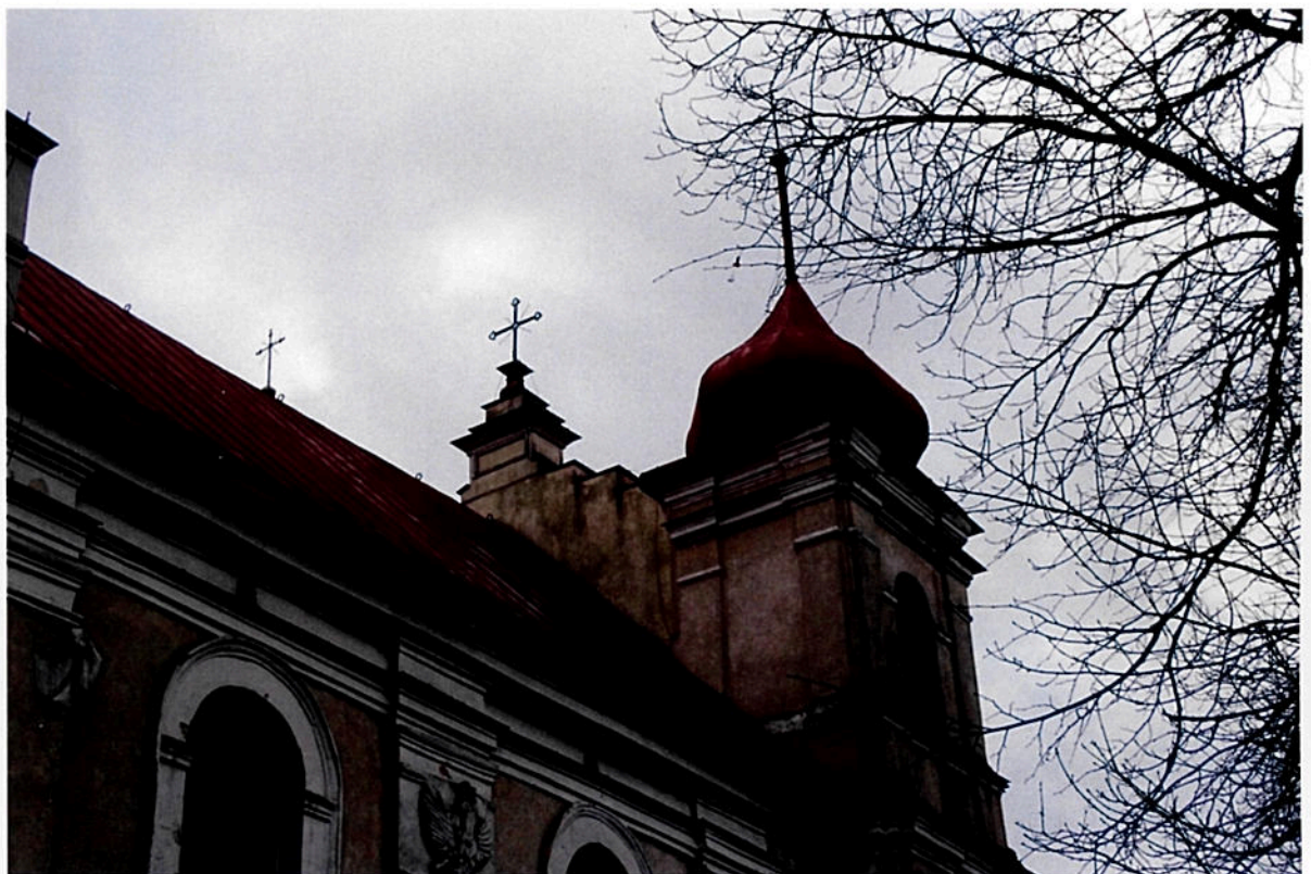
Fot. 13-16 Kościół p. w. Św. Józefa w Markuszowie; widok na elewację północną. Widoczny stan ogólny; tynk przebarwiony, ściemniały, zagłębiony.
