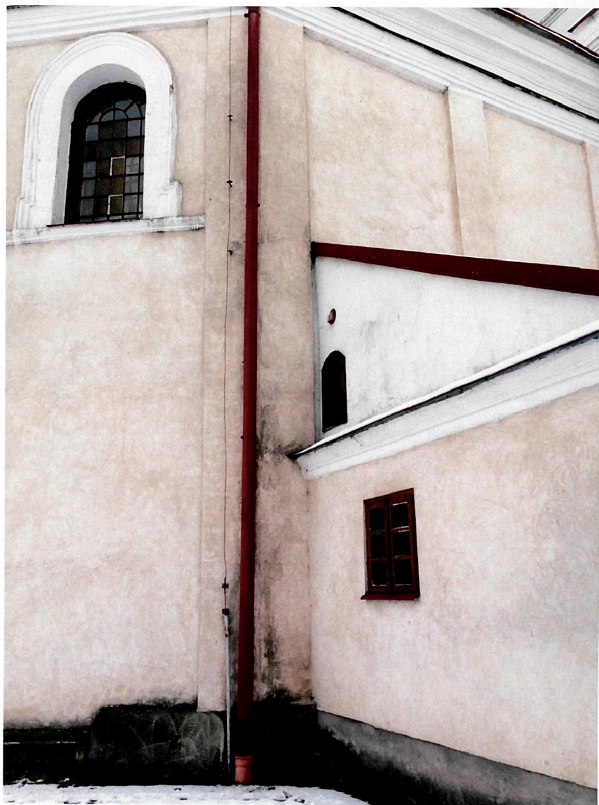
Fot. 28 Kościół p. w. Św. Józefa w Markuszowiec; widok na elewację północną. Widoczny stan cokołu i muru w sąsiedztwie rynny.
