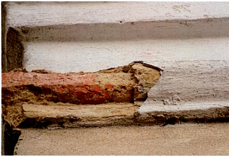
Fot. 41 Kościół p.w. Św. Józefa w Markuszowie. Duży ubytek w profilowaniu gzymsu.
