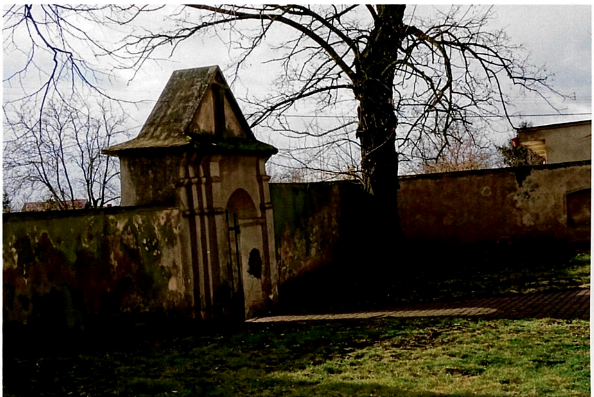
Fot. 53, 54 Teren przy kościele p.w. Św. Józefa w Markuszowie. Mur otaczający dawny cmentarz parafialny, strona południowa. Widoczny stan zachowania. Zawilgocenia, porosty, korozja mikroorganiczna, zasolenia, ubytki tynku.
