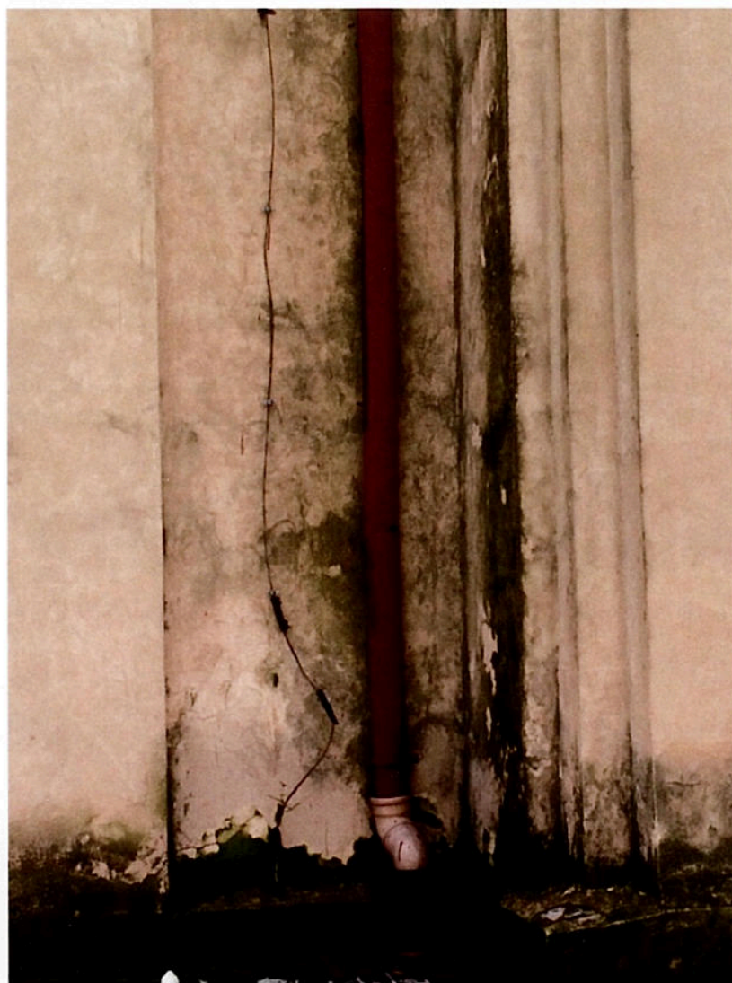
Fot. 20 Kościół p. w. Św. Józefa w Markuszowie; widok na elewację północną. Widoczny stan orynnowania i stan elewacji w miejscu częstego kontaktu z wodą. Zawilgocone, porośnięte glonami, z rozległą korozją mikrobiologiczną fragmenty ścian.
