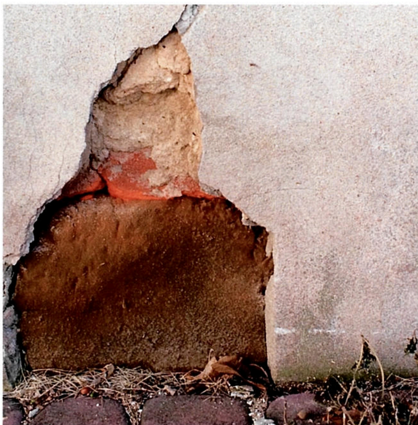
Fot. 40 Kościół p.w. Św. Józefa w Markuszowie. Duży ubytek w strefie cokołu.
