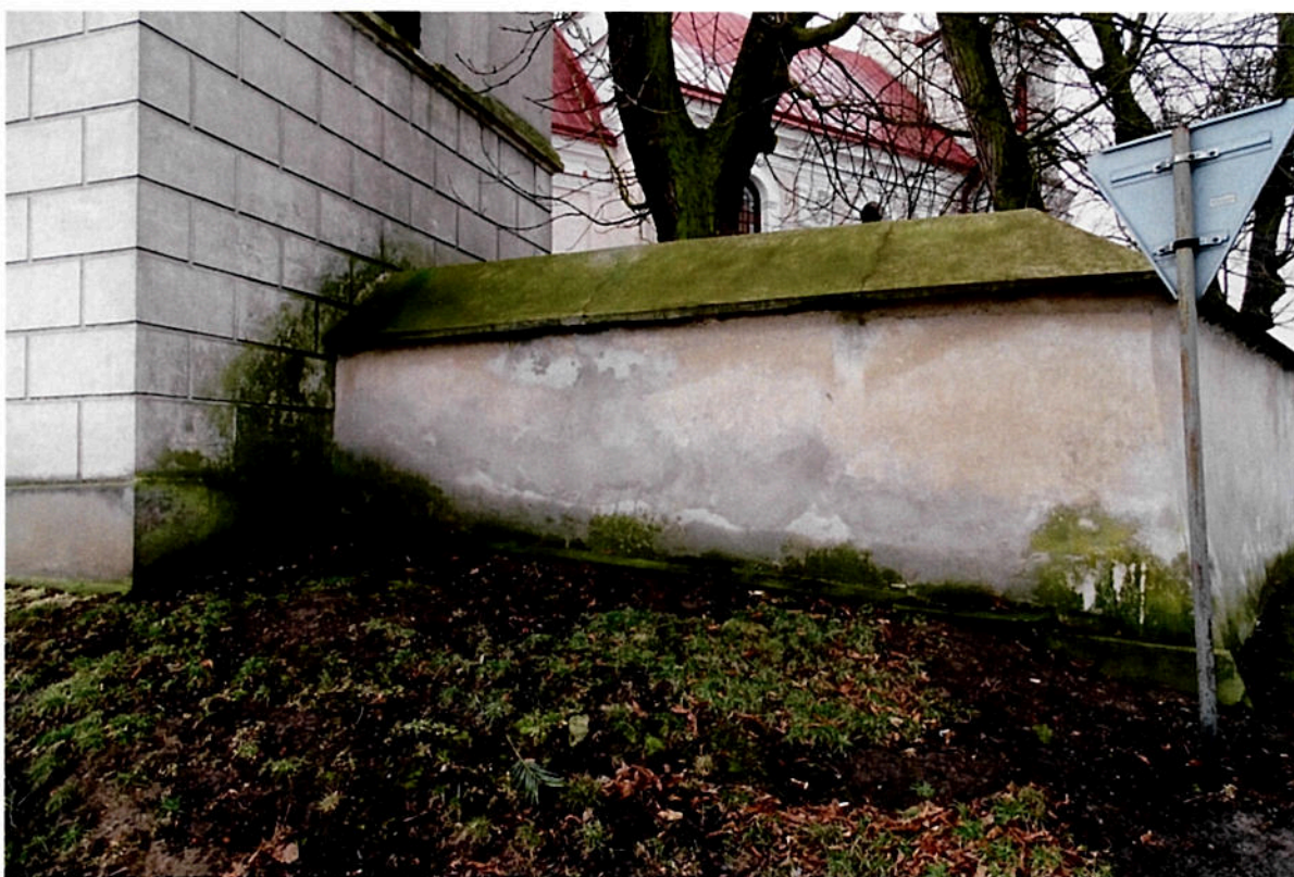
Fot. 57-62 Teren przy kościele p.w. Św. Józefa w Markuszowie. Mur otaczający dawny cmentarz parafialny. Widoczny stan zachowania. Zawilgocenia, porosty, korozja mikroorganiczna, zasolenia, ubytki tynku
