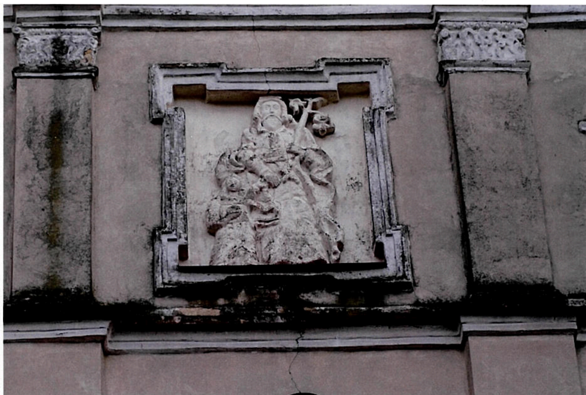
Fot. 3-6 Kościół p. w. Św. Józefa w Markuszowie. Elewacja frontowa, trzy płaskorzeźby umiejscowione wzdłuż trzeciej kondygnacji. Widoczny bardzo zły stan płaskorzeźb; zatracona, uogólniona forma oraz zły stan techniczny na skutek wykonanych napraw i wtórnych nawarstwień cementowych.
