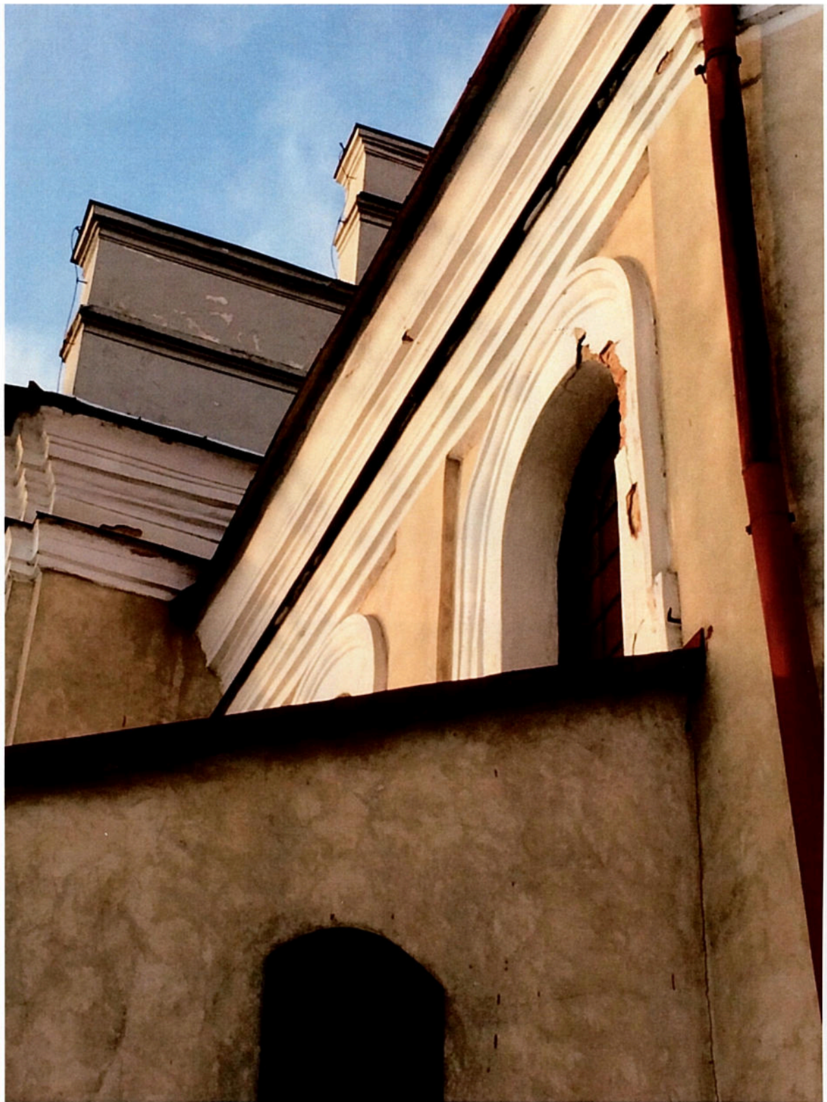
Fot. 30 Kościół p.w. Św. Józefa w Markuszowie. Widoczny stan profili ciągnionych, gzymsów i obramienia okiennego – odpadające fragmenty tynku. Widoczny stan zachowania okien.
