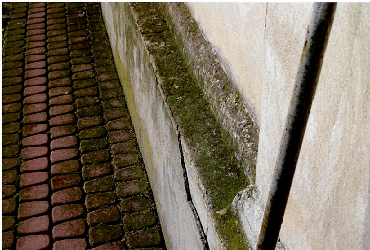
Fot. 36 Kościół p.w. Św. Józefa w Markuszowie. Widoczny stan cokołu – zawilgocenie, mech, korozja mikroorganiczna pęknięcia, odpadanie tynku.
