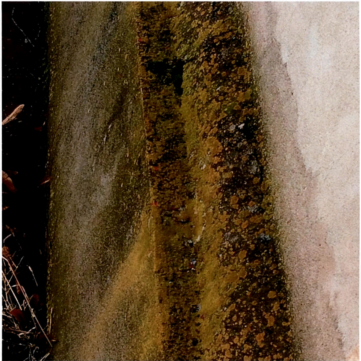
Fot. 35 Kościół p.w. Św. Józefa w Markuszowie. Widoczny stan cokołu zakrystii – zawilgocenie, mech, korozja mikroorganiczna.
