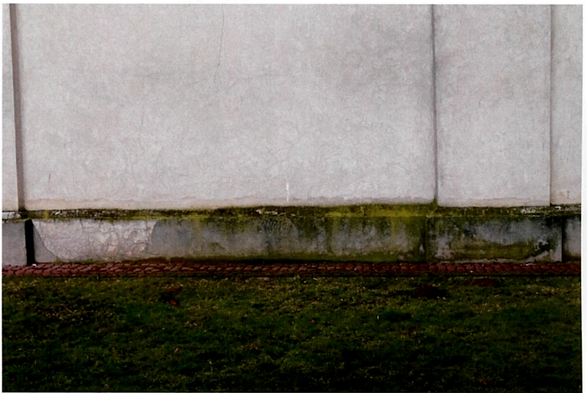
Fot. 17-19 Kościół p. w. Św. Józefa w Markuszowie; widok na elewację północną. Widoczne przebarwienia tynku, zagłoniony, porośnięty mchem cokół budowli.
