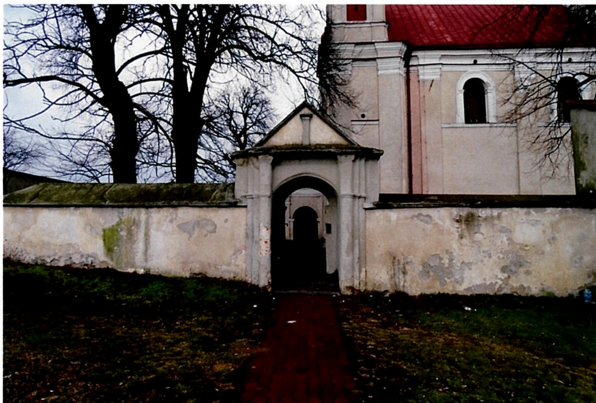
Fot. 55, 56 Teren przy kościele p.w. Św. Józefa w Markuszowie. Mur otaczający dawny cmentarz parafialny, strona południowa. Widoczny stan zachowania. Zawilgocenia, porosty, korozja mikroorganiczna, zasolenia, ubytki tynku.
