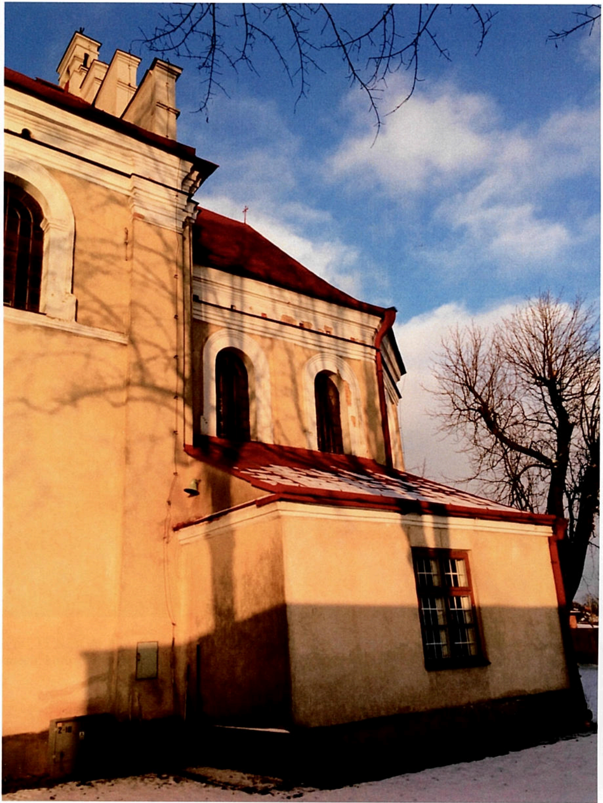
Fot. 34 Kościół p.w. Św. Józefa w Markuszowie. Widoczny stan ściany zakrystii i cokołu – zawilgocenie, korozja mikroorganizmiczna.
