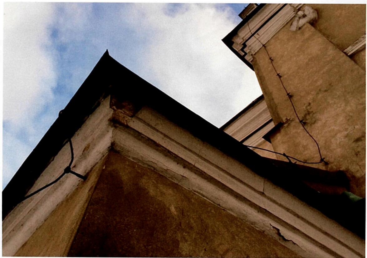
Fot. 26 Kościół p. w. Św. Józefa w Markuszowie. Widoczny stan profili ciągnionych i gzymsów na zwieńczeniu.
