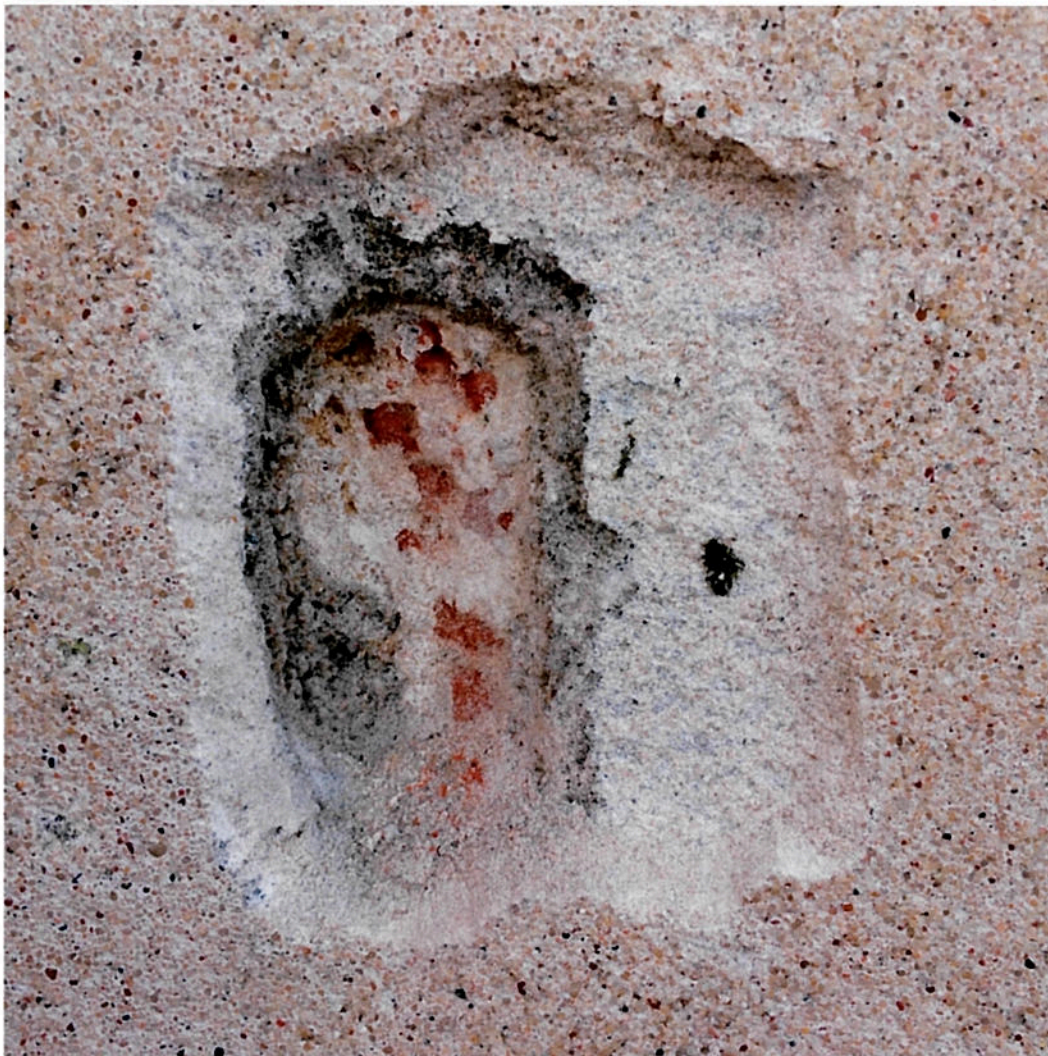
Fot. 42 Kościół p.w. Św. Józefa w Markuszowie. Odkrywka w strefie cokołu. Widoczne trzy warstwy technologiczne / 2 chronologiczne: warstwa chronologiczna nr. 1: wążek ceglano-kamienny; warstwa chronologiczna nr. 2: obrzutka cementowa, a na niej warstwa zaprawy wapiennej.
