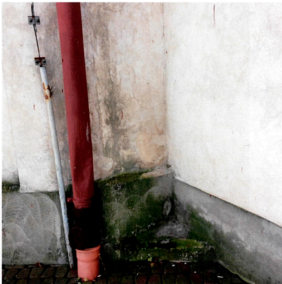
Fot. 37, 38 Kościół p.w. Św. Józefa w Markuszowie. System odprowadzania wody. Widoczny stan muru w stałym, bezpośrednim kontakcie z wilgocią.
