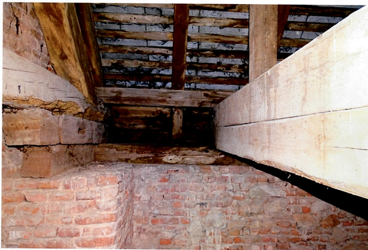
Fot. 49-52 Teren przy kościele p.w. Św. Józefa w Markuszowie. Dzwonnica. Widoczny stan schodów i konstrukcji drewnianych.
