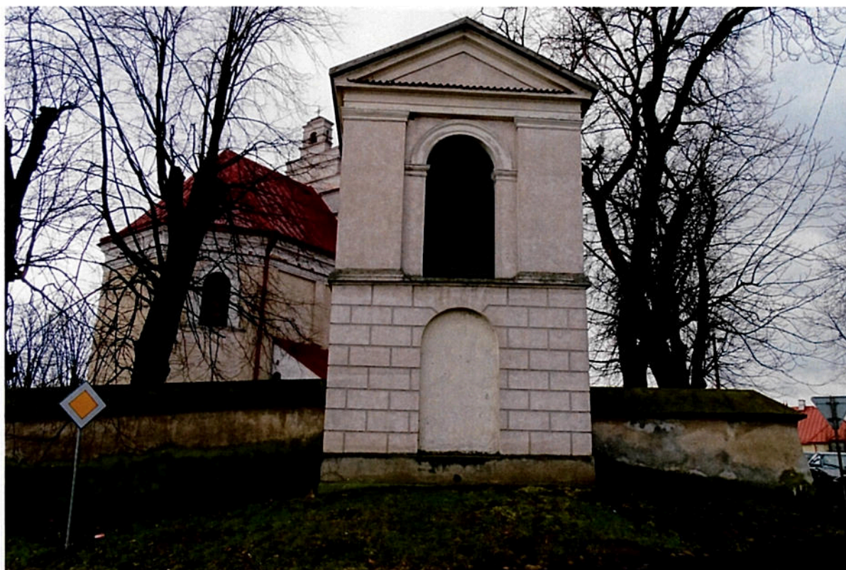
Fot. 43-46 Teren przy kościele p.w. Św. Józefa w Markuszowie. Dzwonnica. Widoczny ogólny stan zachowania muru. Zawilgocenie, porośnięcie mchem i glonami, ubytki w profilowaniach gzymsu, naruszona struktura tynków.
