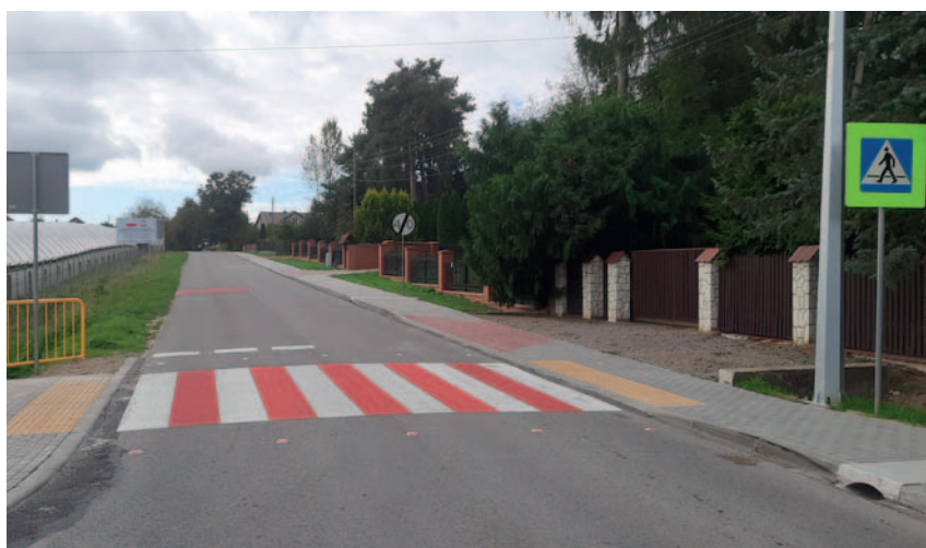
Budowa drogi dla pieszych w ciągu drogi powiatowej nr 2528L w m. Dąbrówka wraz z budową przejścia dla pieszych oraz budową peronu przystankowego
