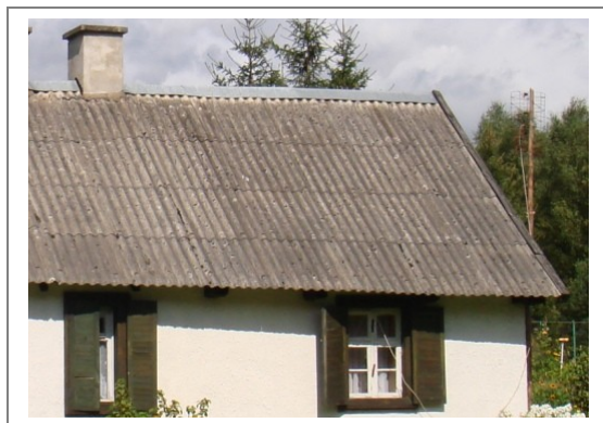
Fot.1 Płyty azbestowo-cementowe faliste
