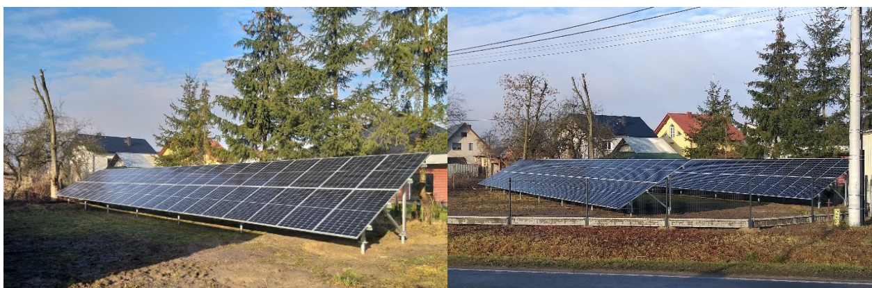
Instalacja fotowoltaiczna do produkcji energii elektrycznej na potrzeby Przedszkola (moc 33 kW)
