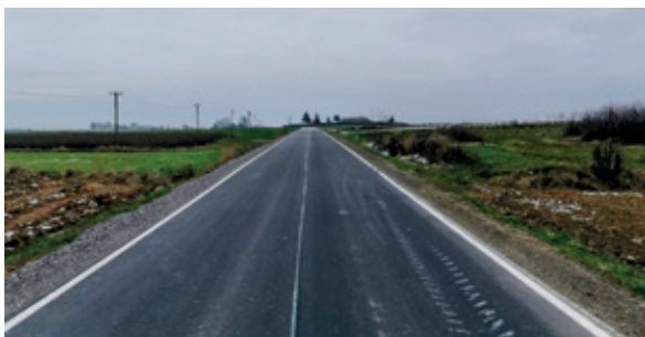
Przebudowa drogi powiatowej nr 2720 Rzeczyca Ziemiańska – Owczarnia – Kraśnik, odcinek ok. 1 km. Wartość inwestycji 1 mln 498 tys. zł.
