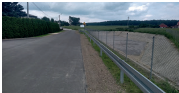
Budowa drogi gminnej nr 108594L Wola Trzydnicka – Agatówka Kopaniny. Odcinek około 730 metrów. Wartość inwestycji 1 mln 212 tys. zł.
