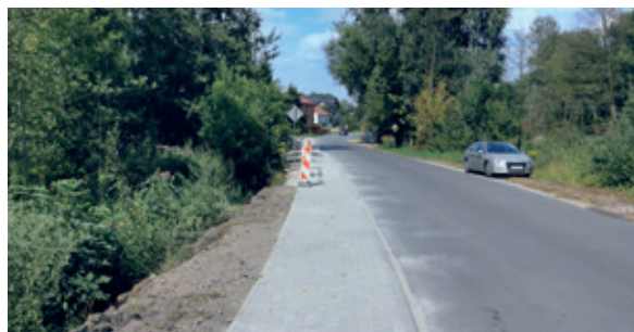
Budowa chodników przy drodze powiatowej nr 2717 Słodków – Węglin, wybudowano ok. 2 km 800 m. Wartość inwestycji 1 mln 31 tys. zł.
