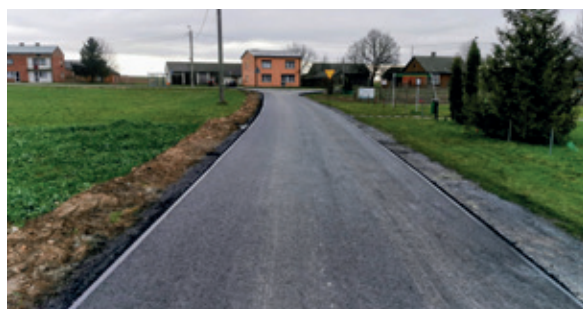
Remont drogi nr 108592 Agatówka koło remizy. Odcinek około 250 metrów. Wartość inwestycji 226 tys. zł.
