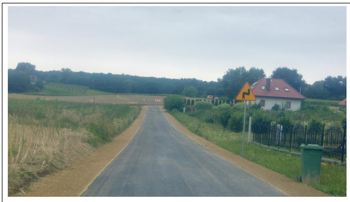
Fot. 5. Przebudowany odcinek drogi gminnej nr 112576L w miejscowości Maszki na długości 835 m.
