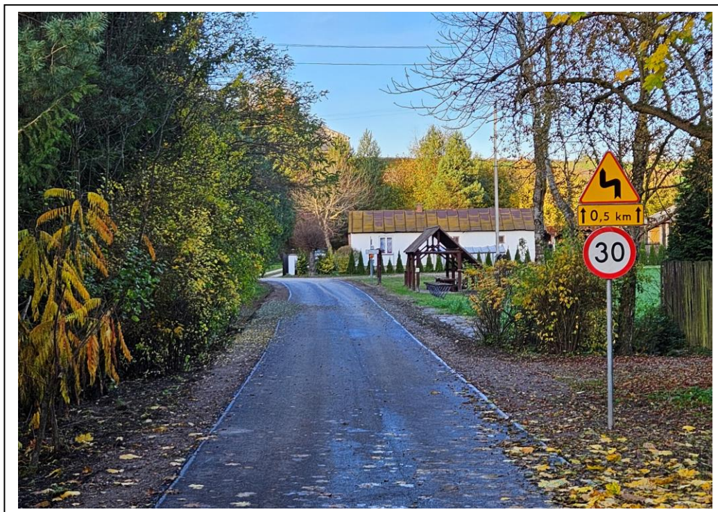
Fot. 23. Przebudowana droga gminna 106910L w miejscowości Nowy Gaj na odcinku 250 m.
