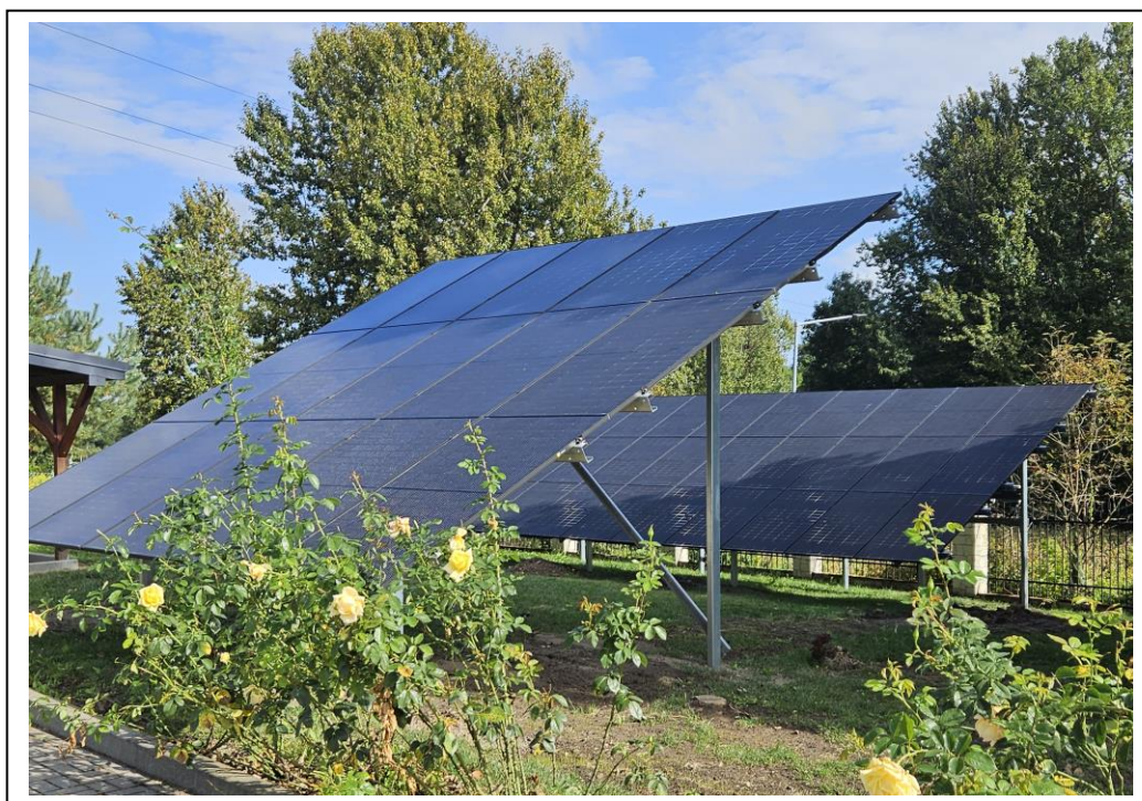
Fot. 10. Instalacja fotowoltaiczna o mocy 30 kWp na terenie Szkoły Podstawowej im. Stanisława Marusarza w Wojciechowie.
