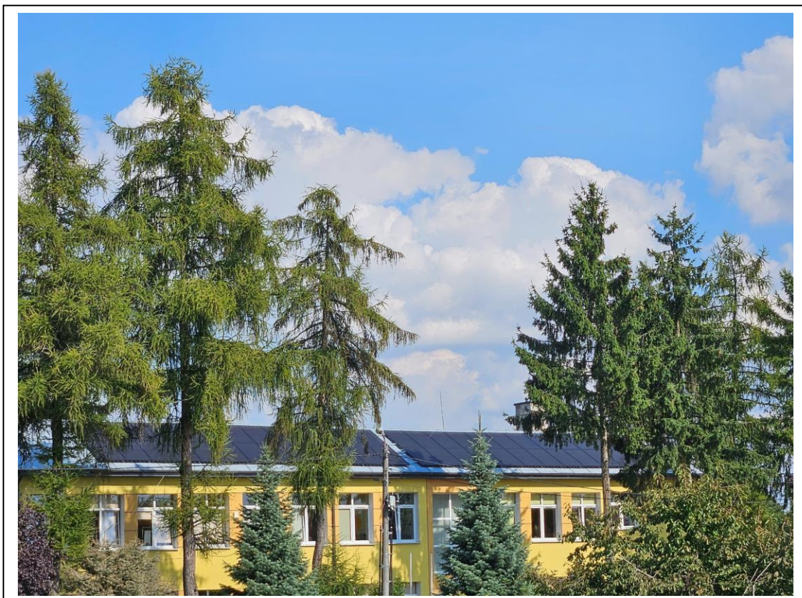
Fot. 8. Instalacja fotowoltaiczna o mocy 20 kWp na budynku Szkoły Podstawowej im. Polskich Olimpijczyków w Miłocinie.
