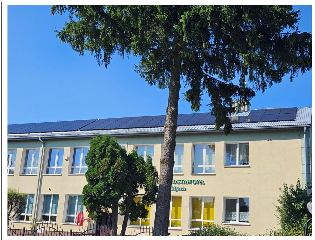
Fot. 9. Instalacja fotowoltaiczna o mocy 30 kWp na budynku Szkoły Podstawowej w Palikijach.
