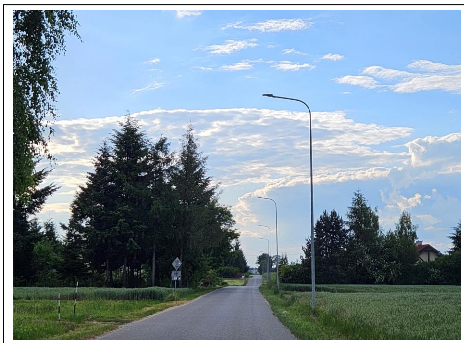
Fot. 22. Oświetlenie drogowe wybudowane w miejscowościach Palikije Pierwsze i Sporniak (wzdłuż Lasu Krzywie) na odcinku 1800 m.
