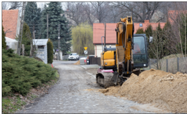
Zniszczony odcinek drogi przy ul. Polnej i Szkolnej w Łażanach już niebawem zyska nową nawierzchnię asfaltową.
