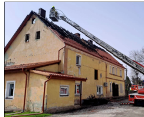
Obecnie budynek po pożarze nie nadaje się do zamieszkania.
