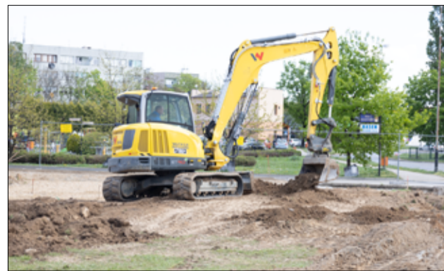
Roboty budowlane w tej chwili prowadzone są przy ul. Piastowskiej w Żarowie.
