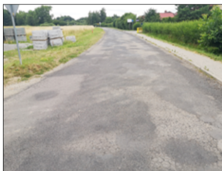
Tak przed remontem wyglądał zniszczony odcinek drogi przy ul. Słowiańskiej w Żarowie.
