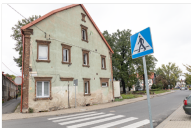
Osiem budynków wspólnot mieszkaniowych zostanie wyremontowanych. Prace najprawdopodobniej ruszą w przyszłym roku. Na zdjęciu budynek przy ul. Dworcowej 2, który również doczeka się termomodernizacji.
