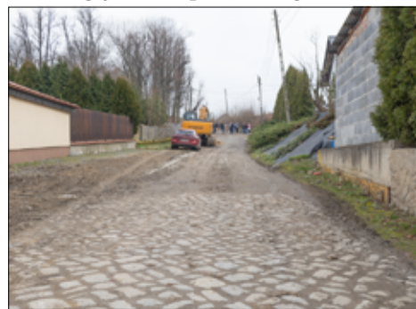
Zniszczony odcinek drogi przy ul. Polnej i Szkolnej w Łażanach przed remontem.
