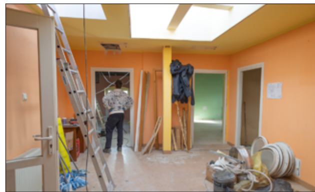
Firma wykonawcza rozpoczęła prace od remontu dachu. Realizowane są również roboty wewnątrz budynku.
